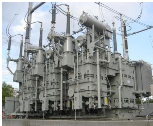
Transformador trifásico com divisão especial
